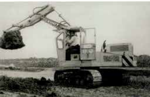
1962: intervento in località Brezza per straripamento fiume Volturno
